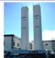
ニチコン製箔株式会社 大町工場 LNG（天然ガス）タンク
