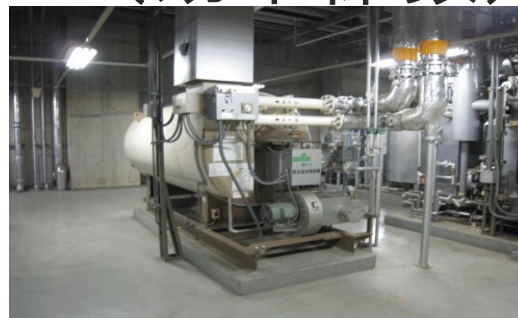
温水ボイラー
