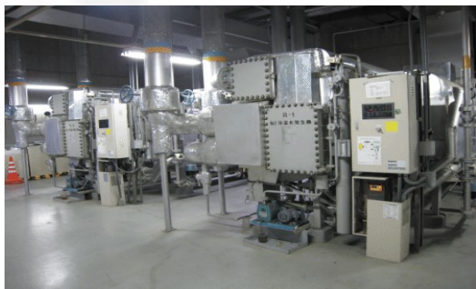
ガス直火焚吸収式冷凍機
