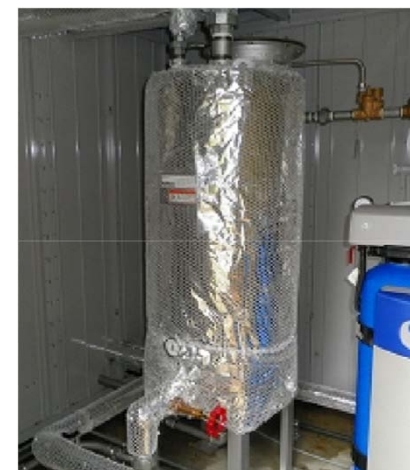
高温水回収タンク
